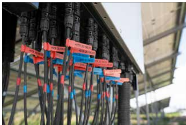
Repère qui facilite l'identification des câbles sur les panneaux solaires.
