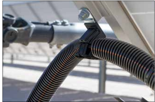
Management de câbles sur installation solaire.
